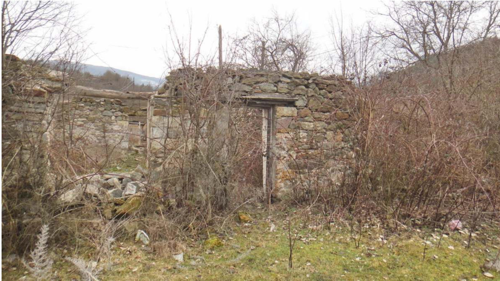
Стены разрушенного строения
